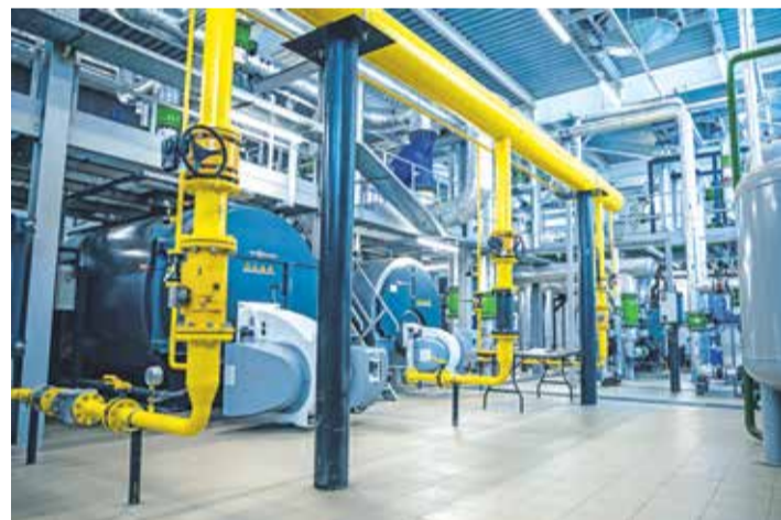
Новая котельная уже обслуживает оба здания электродепо
