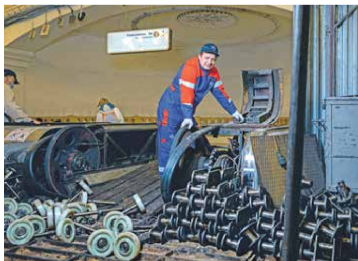
Регулярный ремонт эскалатора позволяет продлить срок его безопасной эксплуатации
