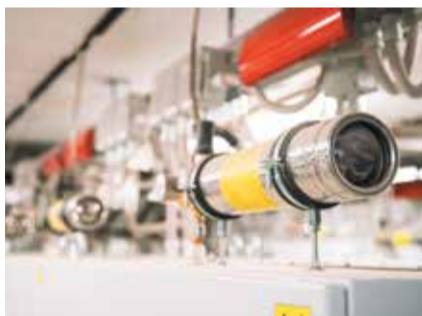
Датчики пожаротушения в машинном зале
