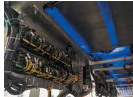
Автоматическая система управления эскалаторами нового поколения в машинном зале
